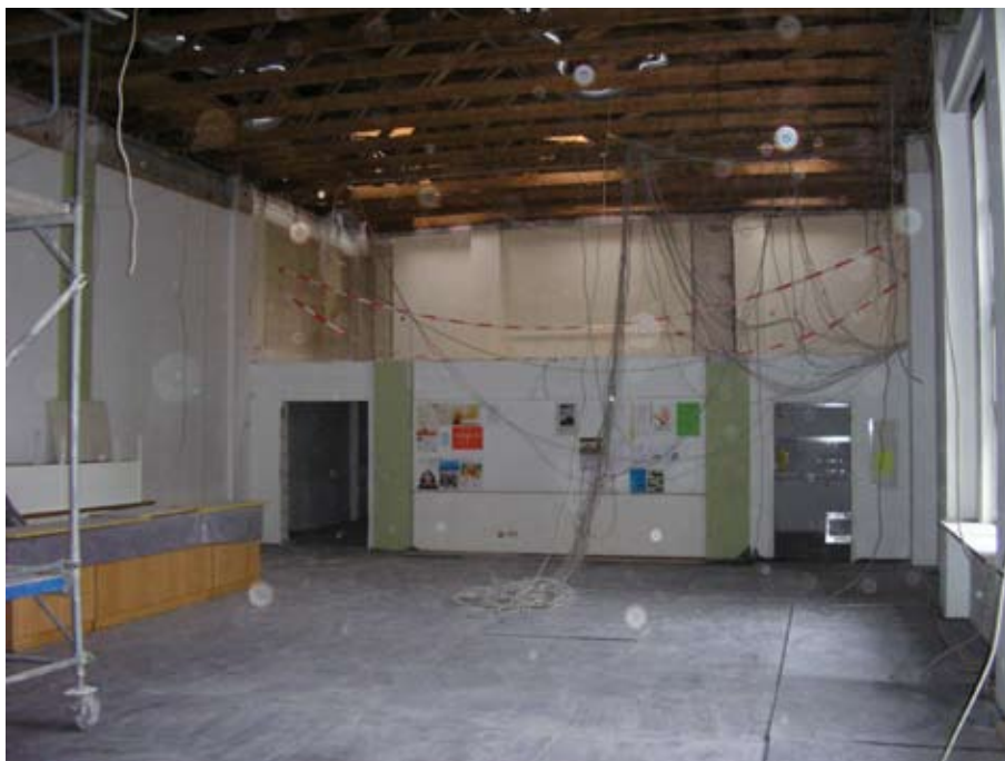
Blick vom Saal in den Raum im ersten Stock, der früher einmal die Gemeindebibliothek beherbergte und als Raum für den Feierabendkreis von Schwester Irma diente.. Die Wand zum Saal wurde herausgebrochen und wird durch eine Glaswand ersetzt. Foto: W. Vieweg
